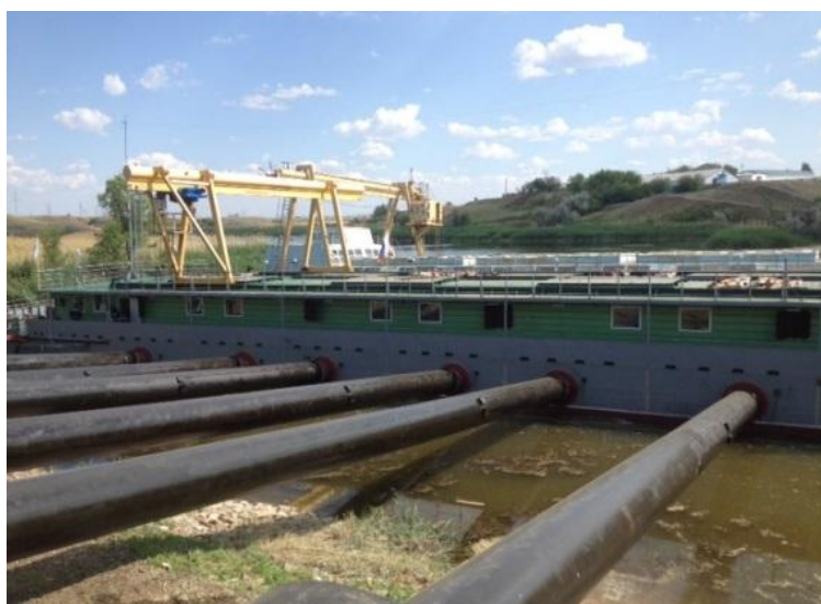
Рисунок 9 - Насосная станция на реке Волга, 2022 год [7]
